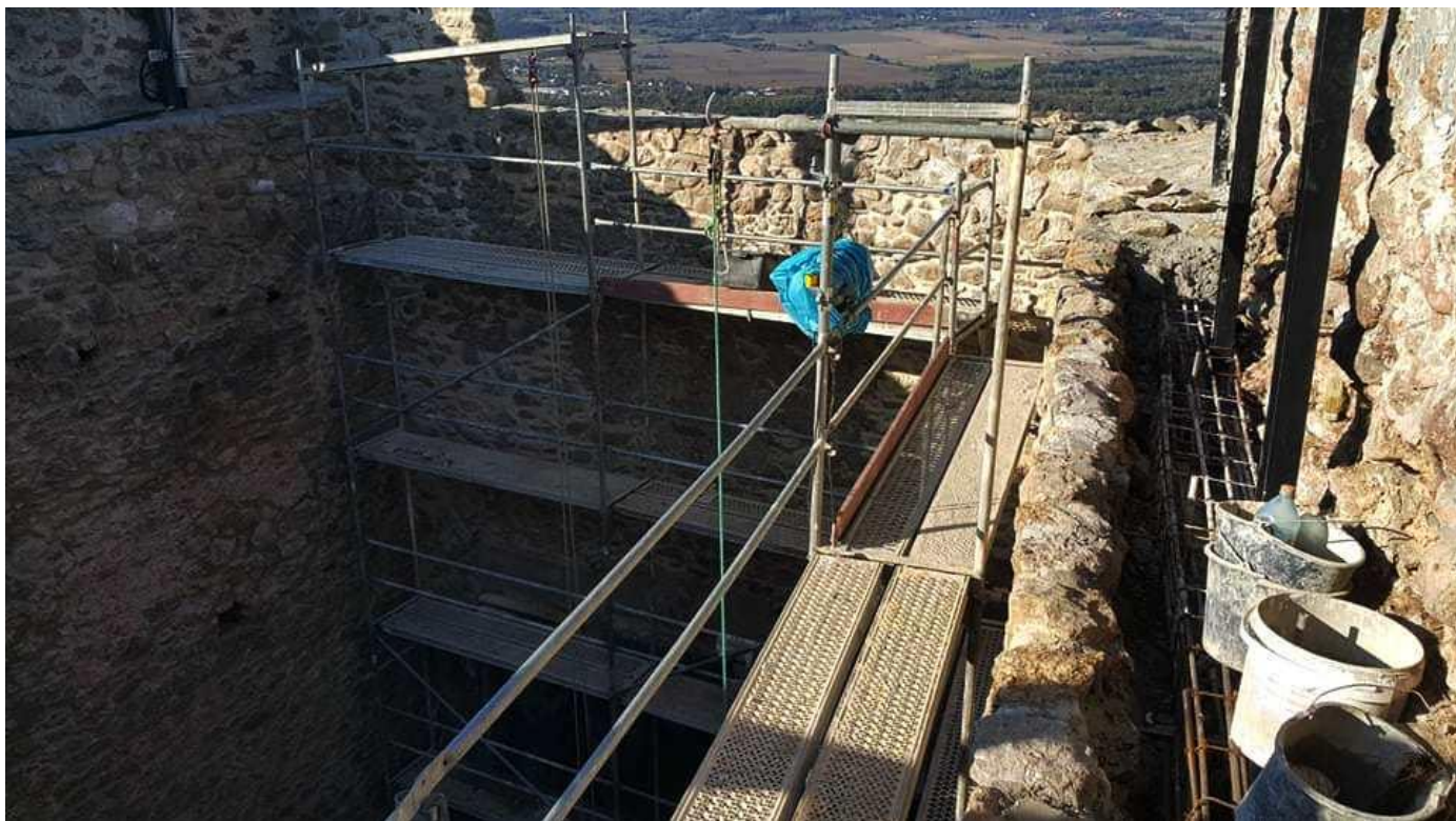
Fot. 8. Montaż wieńca żelbetowego oraz stalowych elementów wzmacniających EW2 w murze wschodnim
